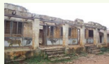
震災の4ヵ月後に訪問調査した時のラムサハ高校(ゴルカ郡)。完全に屋根が崩落した校舎や壁に亀裂が入った校舎がそのまま残されていました。
